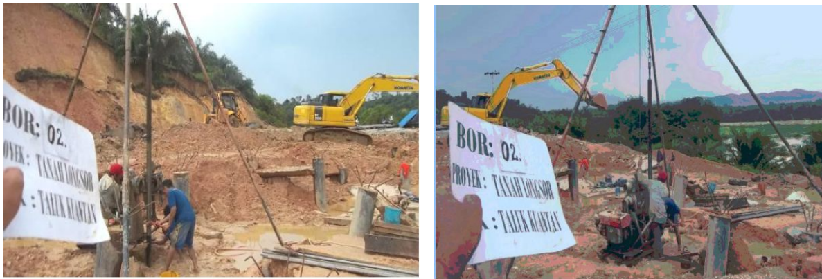
Gambar 3. Terjadi Longsor Pada Saat Pengerjaan Lantai Bertiang (Pile Slab) (Tahun 2015)
